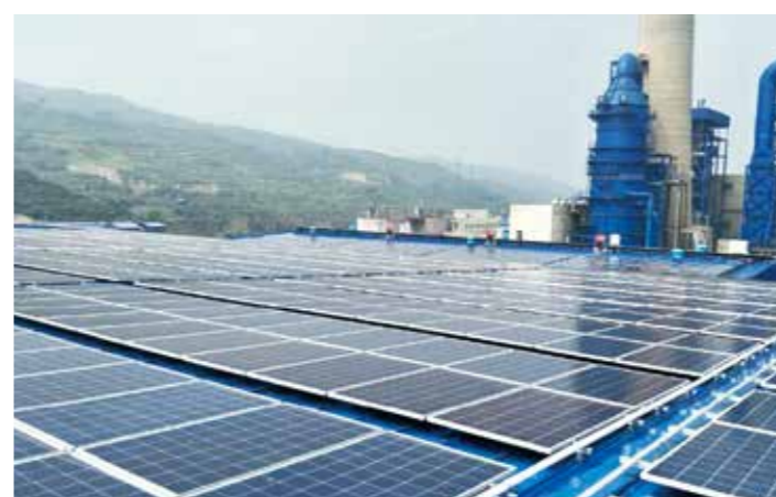
山西汾矿50kW组串式逆变器项目
