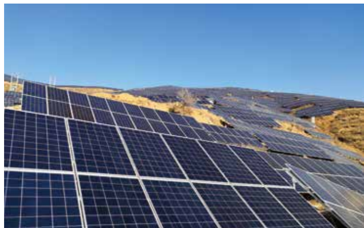
河北保定涞源村级21.48MW光伏扶贫电站项目
